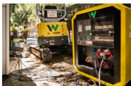
Mobil strømtilførsel? Charging Box. ✓
